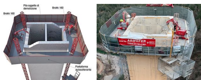
Figura 3-14 – Alternativa 2A e 2B – Demolizione della pila dalla sommità, per H elevate
